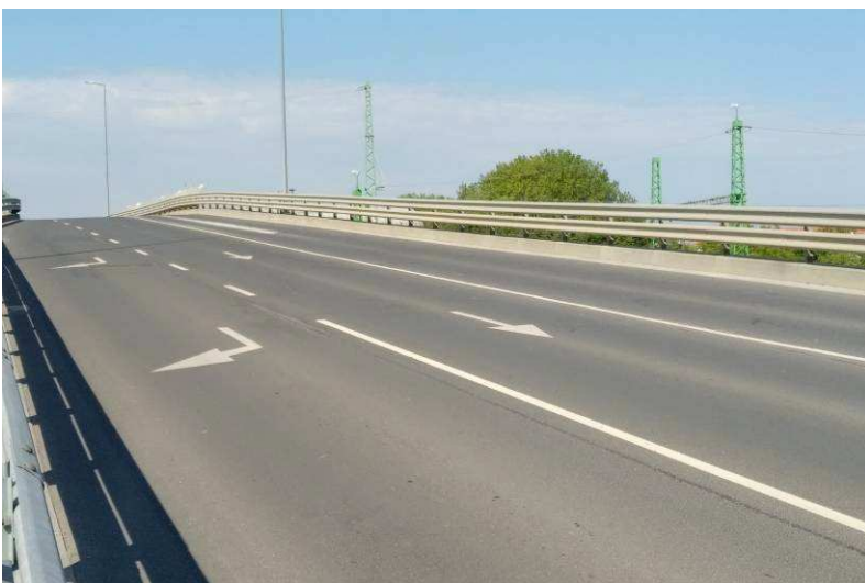
21. kép: K-i oldal Burkolat, korlát, szegélyek állapota megfelelő.
