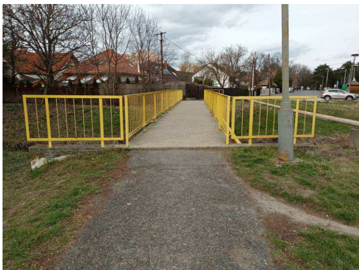
1. kép: Pályanézet, támasz felett keresztirányú repedés
