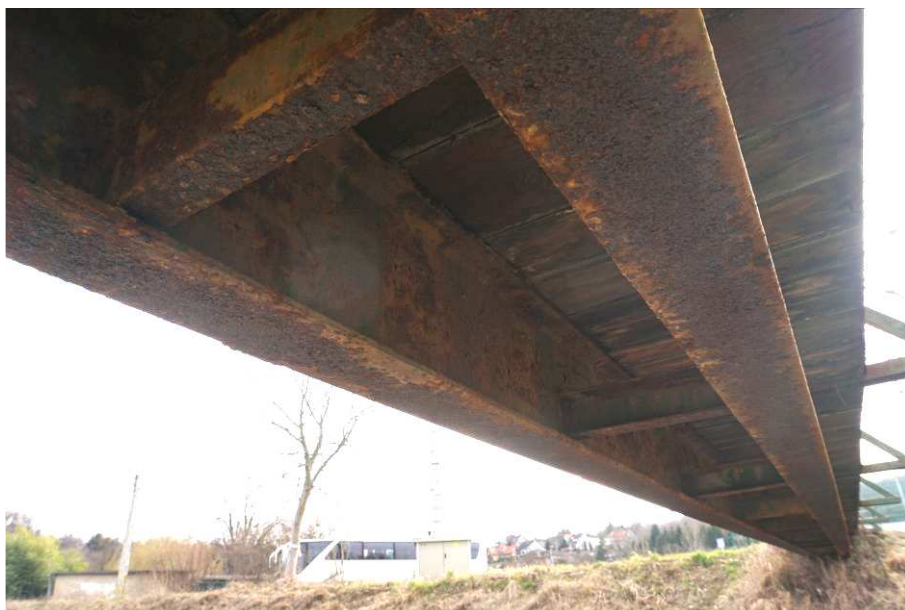
4. kép: Az acél főtartók és keresztgerendák erősen korrodáltak.
