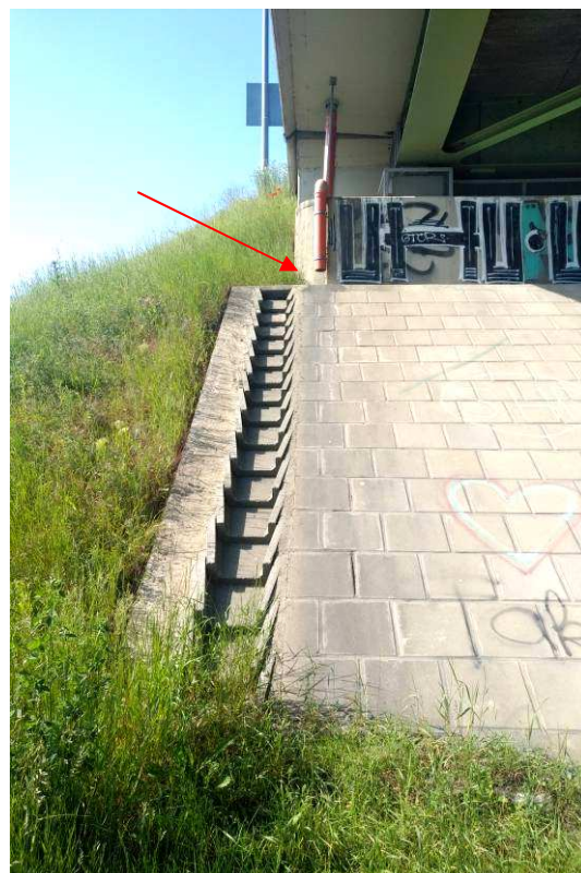
27. 28 képek: A vízvezető cső nem a surrantófejnél végződik, így a csapadék az előrézsűn folyik le. A dilatáció vízvezető csöve nincs a vízvezető rendszerbe kötve, így a térdfalon és a hídfőn folyik le a víz korróziót okozva.
