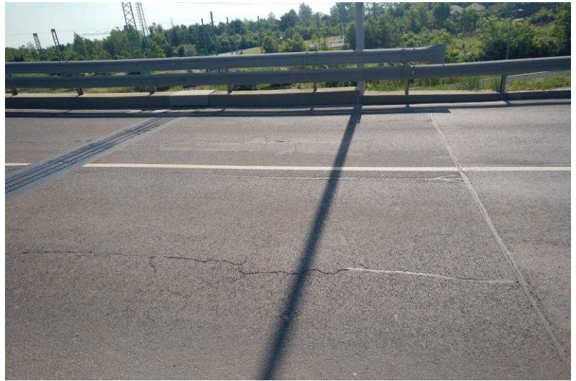
34. kép: Kiegyenlítő lemez felett a burkolat repedezett, egy része kiöntéssel javítva.
