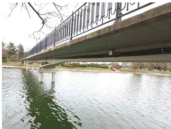
5. kép: Főtartó szélvédett oldalán madarak telepedtek meg, ürülékük a tartószerkezetet szennyezi.
