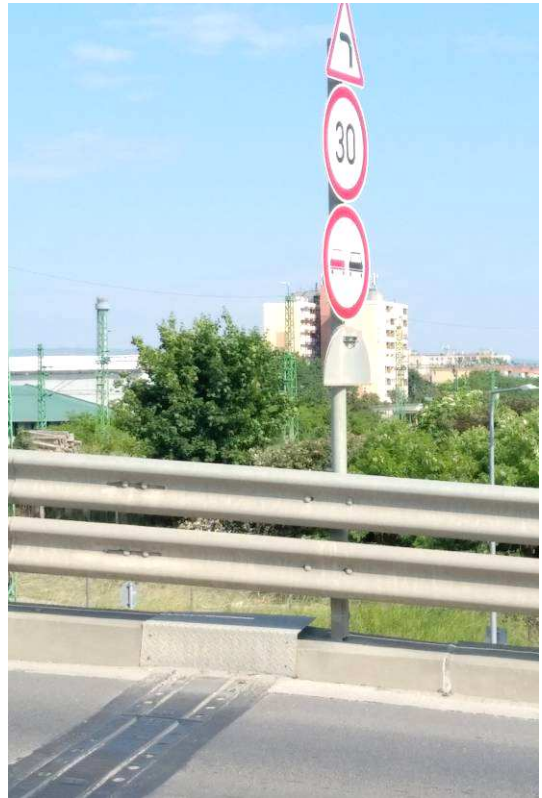
19. kép: KRESZ táblák és korlát állpota megfelelő, aa dilatáció szegély feletti szakasza nem vízzáró.
