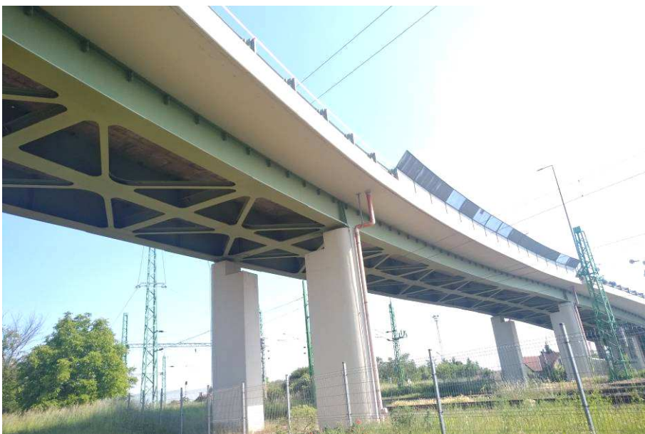
22, 23, 24 képek: Tartószerkezetek, korlátok, MÁV védelmi berendezések, közvilágítási berendezések állapota megfelelő. A burkolaton kisebb foltokban szennyeződés van.
