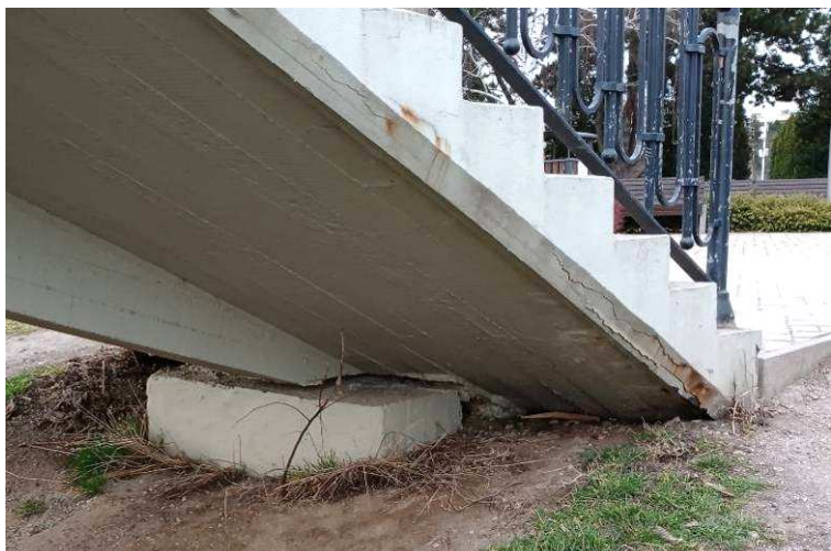
3. kép: A lépcső oldalán repedések, rozsdás lefolyások, az alsó felületen pontszerű korrózió látható. A Kenderesi utca felőli lépcső hátoldalán lévő betongyám megsüllyedt. Szerepe a terv ismeretében határozható meg.
