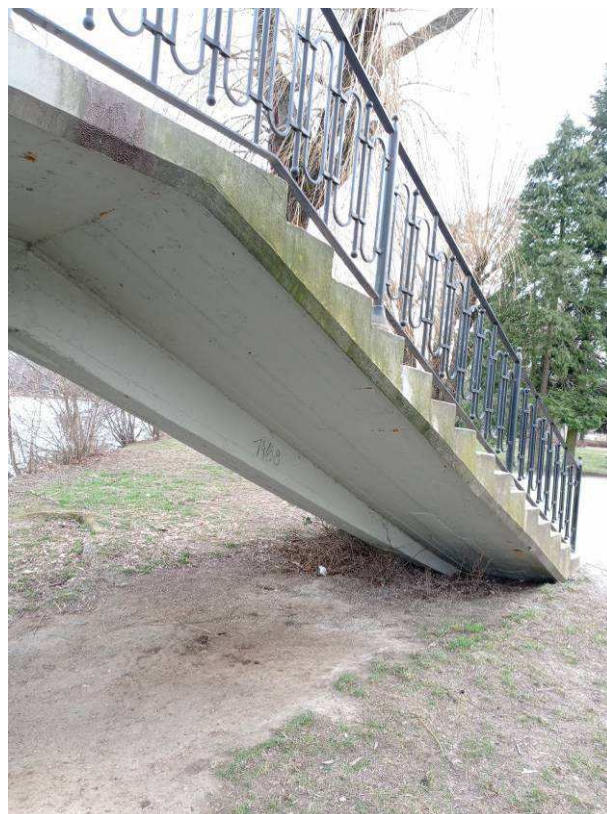
4. kép: A lépcső alsó felületén korróziós foltok vannak. Sziget felőli oldal.
