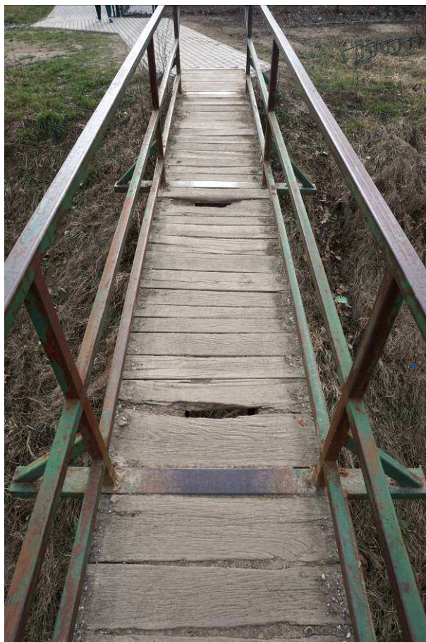
3. kép: Pallóterítés korhadt, több helyen lyukas, balesetveszélyes. Az acélkorlát korróziós, a függőleges pálcaosztások hiányoznak.
