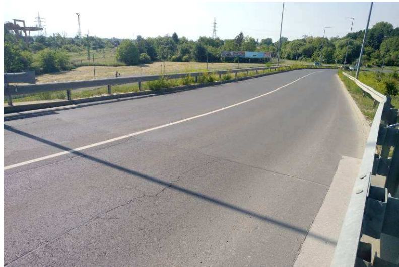
35. kép A korlát a hídvége után deformálódott.
