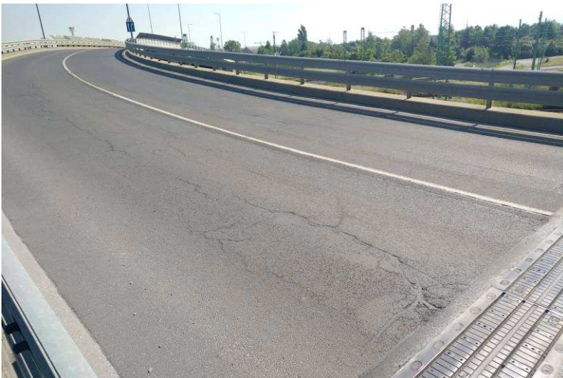
32. kép: Dilatációnál a burkolaton kezdődő kátyú, a pályaburkolatnál enyhe burkolati Repedések.
