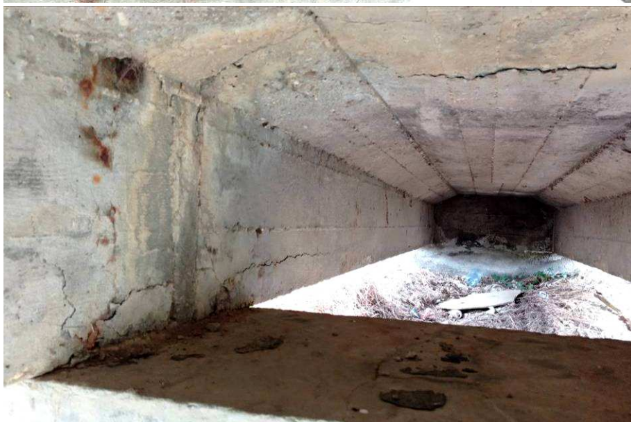
4, 5 képek: Támasz felett a pályalemez átrepedt, leázások, a főtartók végein repedések, betonleválás, acélkorrózió. A leázás a pillért és a felszerkezeti gerendát is állandóan eléri.
