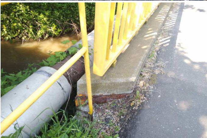
7. kép: A hídvégeken nincs surrantó kialakítás a csapadékvíz megfelelő elvezetéséhez, így a csatlakozó töltés erodál és üregelődés alakul ki. A közmű szabálytalanul közel van a hídhhoz, így a vízvezetés megfelelő megoldása nehezkessé válik.
