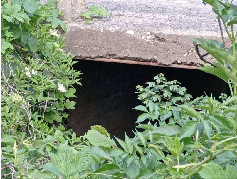
3. kép: A felszerkezet szélein vízorr, kiemelt szegély nincs. A víz a vb. lemez oldalán folyik le. Betonacél kilátszik.
