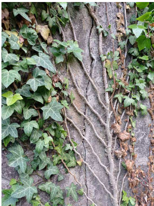
3.kép: Befolyási oldal jobb szárnyfal. A szárnyfal függőleges repedése mentén elmozdulás látható.
