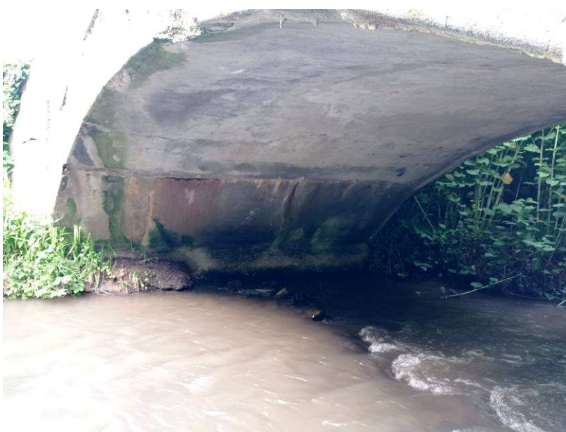
4. kép: A boltozat alsó síkján leázások, melyek különösen erősek a széleken, illetve az alsó részeken húzóó munkahézagból adódóan. A híd előtt a meder sodorvonala balra húzóóott.
