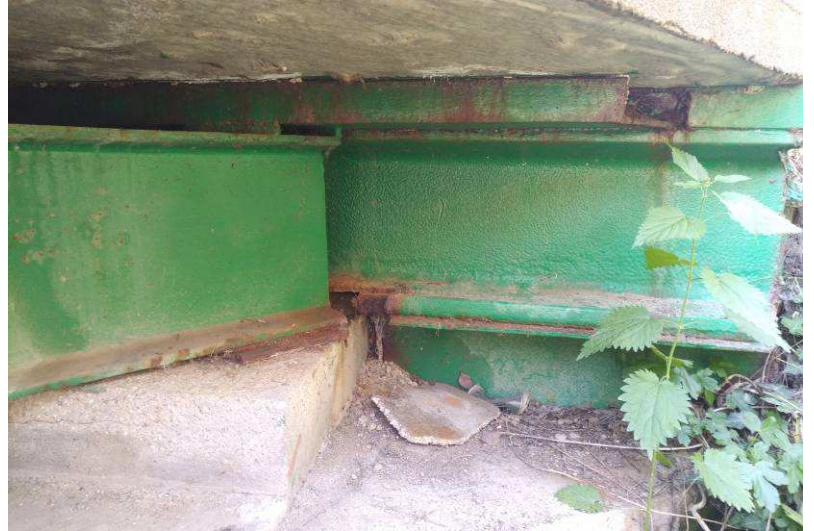
9. kép: Pályalemez alsó síkján meszes kiválások, acéltartók korrodáltak. A hídfőknél lévő felfekvések mentén a korrózió jelentős mértékű. A vb. felszerkezet végén nincs víz-orr kialakítás.
