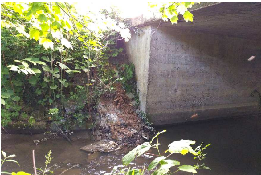
5. kép: A szárnyfal és a hídfő betonfelülete fészkes, cementpép hiányos. Rakott kövekből álló rézsűbiztosítás megbomlott, a meder szemetes.
