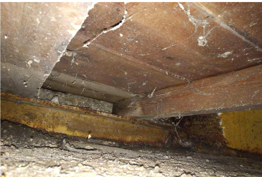
5. kép: A hídfők feletti szerkezeteknél a leázás következtében a korrózió jelentősebb mértékű.
