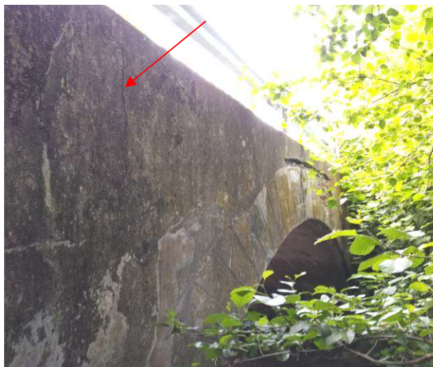
5.kép: Kifolyási oldal. A szárnyfal függőlegesen repedt.
