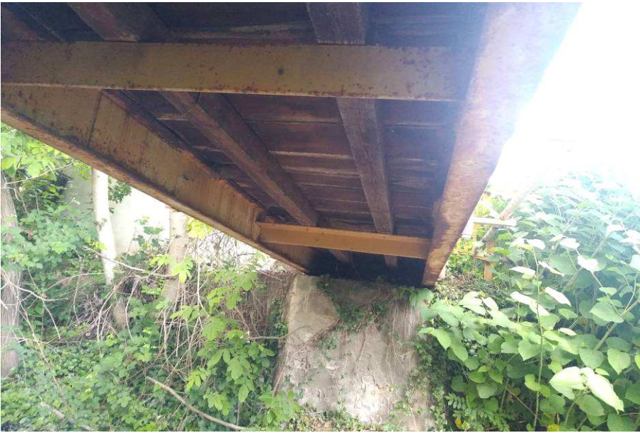
3. kép: Korrodált acélszerkezetek. A fapadlók áznak, megindult a korhadás. A rézsű növényzettel benőtt. Hídfők felülete repedezett, mállik.
