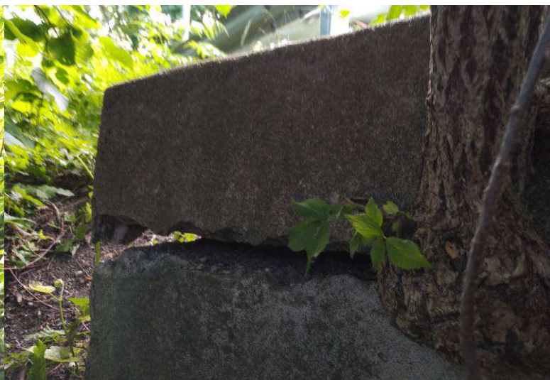
6. kép: Kifolyási oldal jobb oldal. A benővő növényzet a szegély betonját szétrepesztette. A beton gyenge minőségű, betonacél nincs a szerkezetben.
