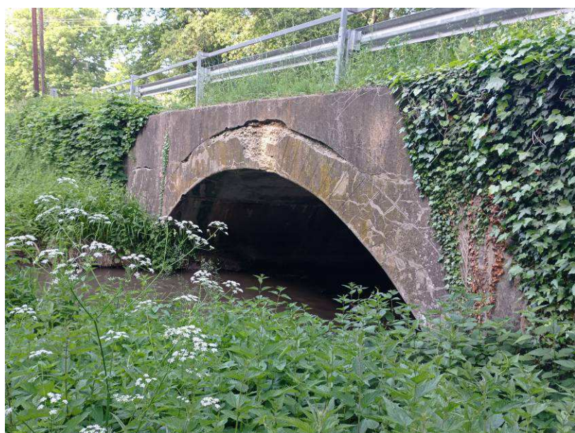
2. kép: Oldalnézet (befolyási oldal) Jelentős betonleválás. A boltív és a szegélygerenda elvált egymástól. A beton gyenge minőségű, betonacél nincs a szerkezetben
