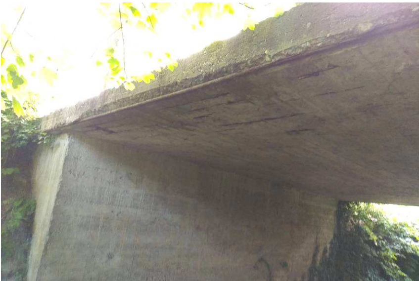
4. kép: A pályalemez alsó felületén a fővasak láthatók, korrodáltak. A felszerkezet átázik. A hídfőn vízfolyás nyoma látható.
