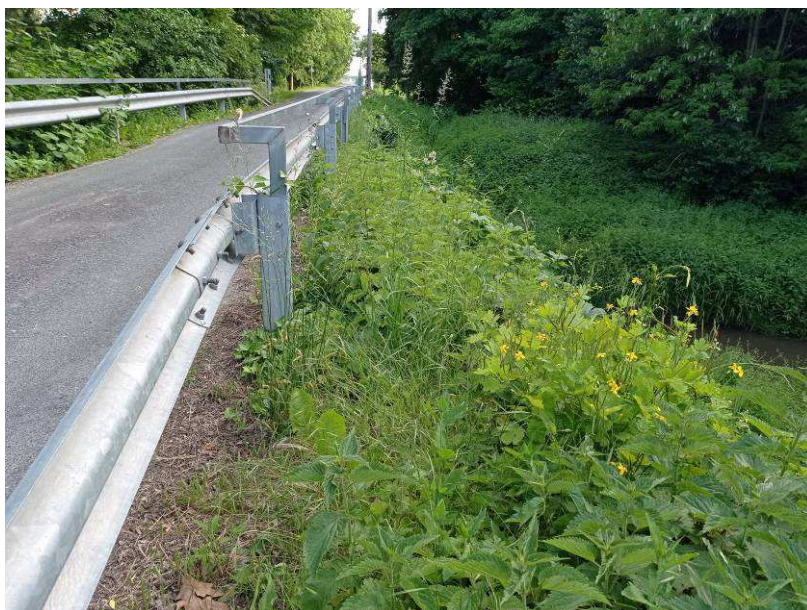
8. kép: Kiemelt szegély nincs kialakítva a hídon, a korlát sávjában erős növényzet van, a csapadék közvetlenül a tartószerkezetbe jut.
