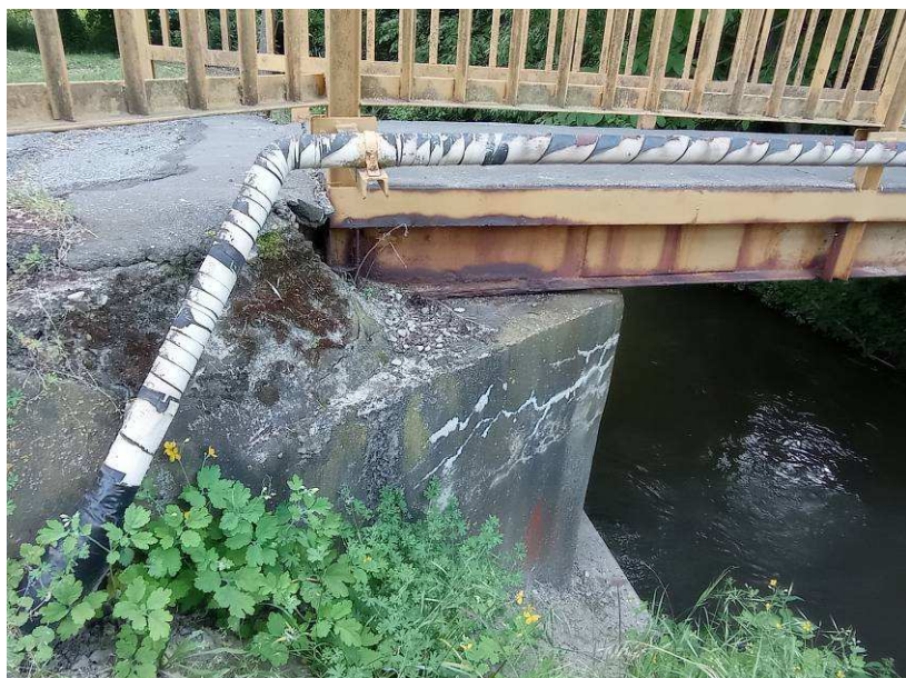
7. kép: Kifolyási oldal. A hídfők leáznak, repedezettek, az acélgerendák erősen korróziósak. A korlátra szabálytalanul rögzített gázvezeték látható.
