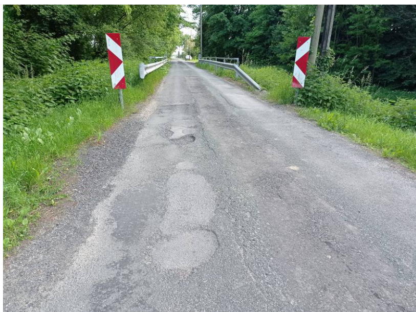
1. kép: Pályairányú nézet Csatlakozó burkolat repedezett, kátyús, megsüllyedt.
