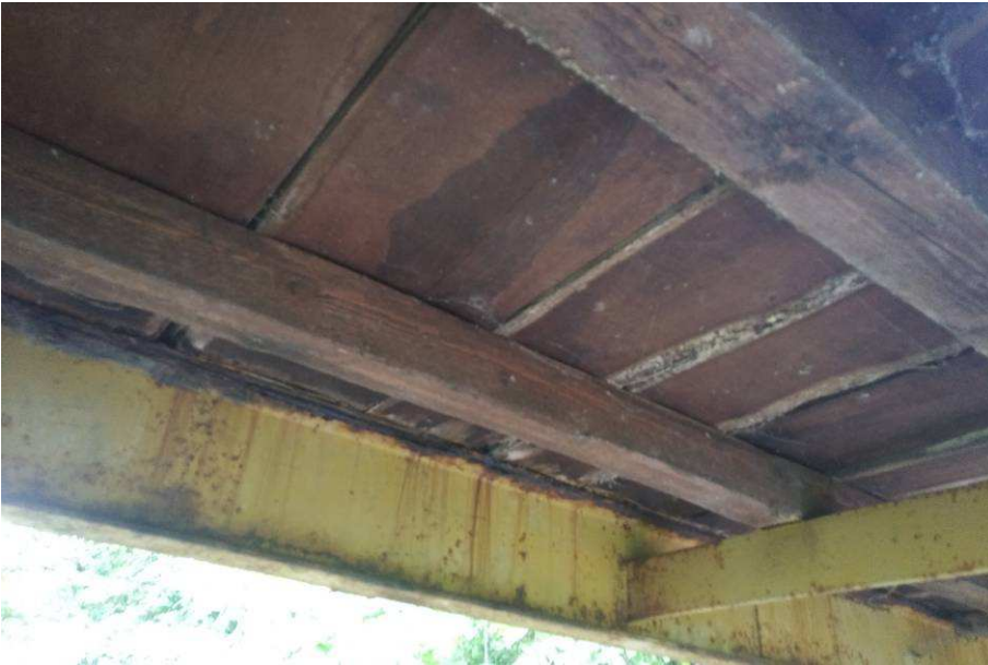
4. kép: Korróziós acélszerkezetek, és korhadó faszerkezetek.
