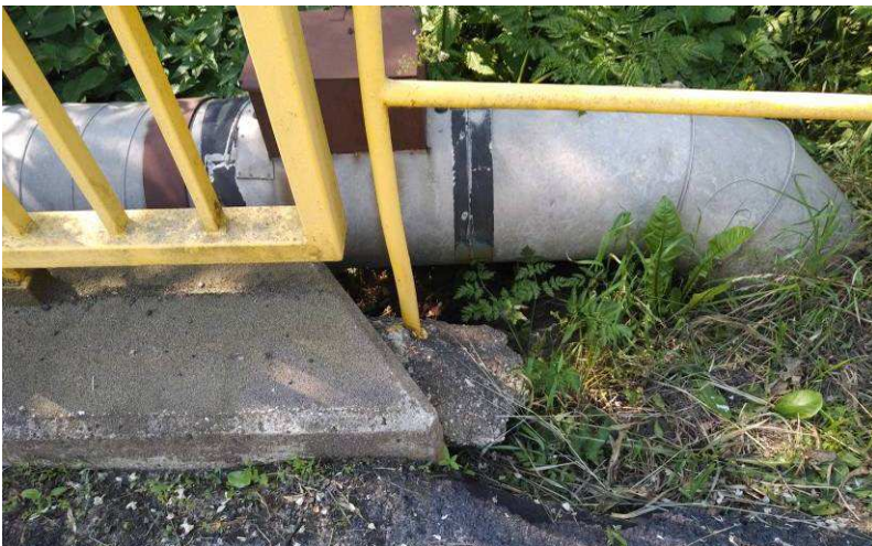
6. kép: Csatlakozó aszfaltburkolat alatt üregelődés látható, a korlát rögzítése instabillá vált.
