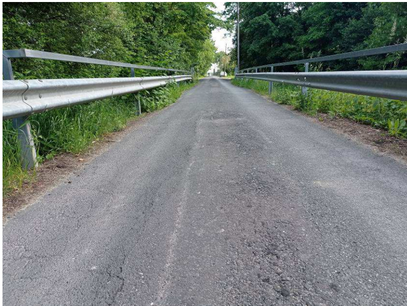
7. kép: Repedezett, kátyús, megsüllyedt burkolat a hídon.
