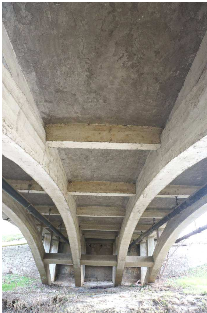
12. kép. A híd tartószerkezeti elemein – pályalemez, főtartók, keresztartók, oszlopok - és azok csatlakozásánál repedések láthatók, melyeket az előző hídvizsgálat is leírt.
