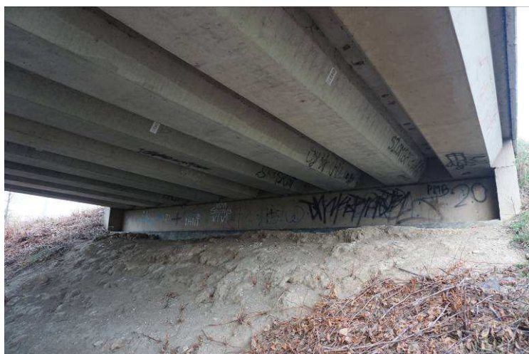
7. kép: Az előrészsík burkolata hiányzik, a cölöpössze-fogó gerenda szigetelt felülete kilátszik a terepsíkből. A cölöpök még nem láthatók. A felszerkezeti gerendák alsó síkja jó állapotúak.
