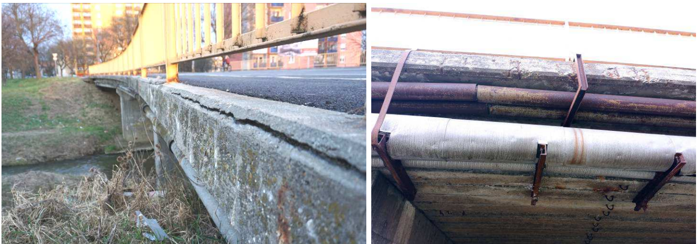
5. 6. képek: Ázás nyomok, mészkiválás a szélső tartók alatt, a közműtartók erősen korróziósak, a konzolvég-re rábetonozott réteg levált. Korlátfelületek korróziósak.
