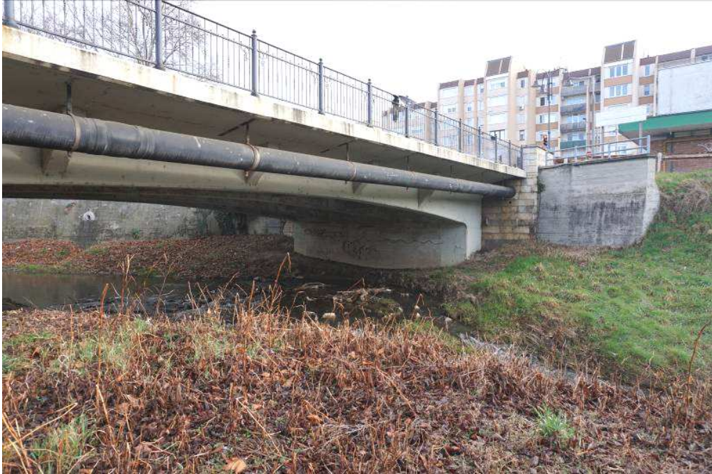
7. kép: Konzolvégen korróziós lefolyások a korlátoszlopok felől. A közmű tartóbilincsek korróziósak, a hídfő jobb végén bevonat leválása látható. A meder elfajulása az alépítményt veszélyezteti. A hídhöz csatlakozó támfal ép.
