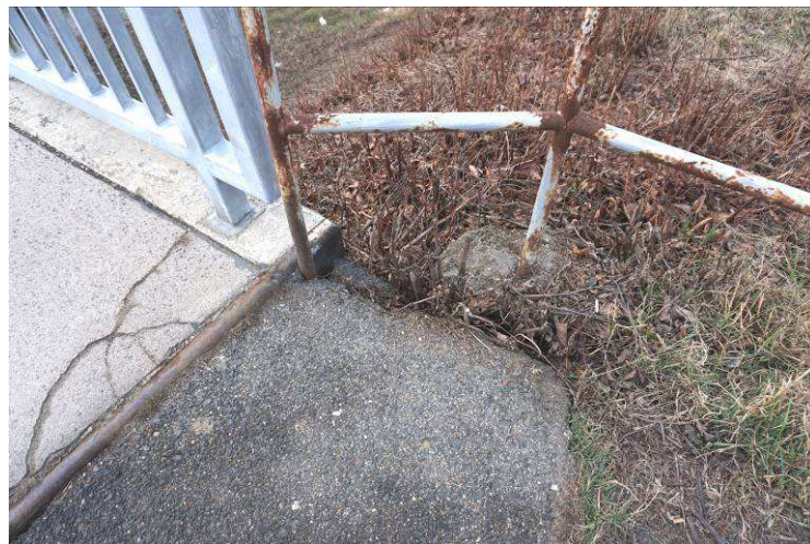
8. kép: A hídvégen lévő csatlakozó járda oldalsó megtámasztása kimozdult, a járda kezd megsüllyedni.
