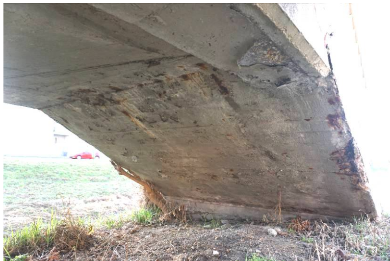
5. kép: Betonleválások, acélkorrózió, meszes lefolyások. Rosszul szigetelt a szerkezet.
