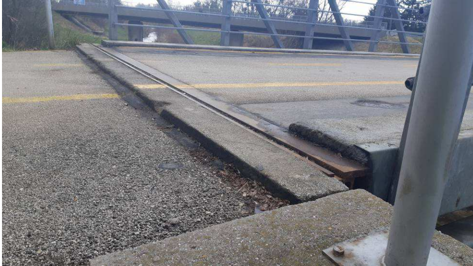
3. kép: Hídvégeken a dilatációk eltömődtek, rajtuk keresztül a csapadék a hídfőkre jut. A dilatációk korróziósak.
