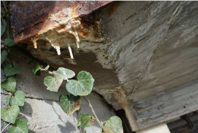
8. kép: Dilatáció alatti felszerkezet. A felszerkezetten a csapadék hatására erős korrózió alakult ki.
