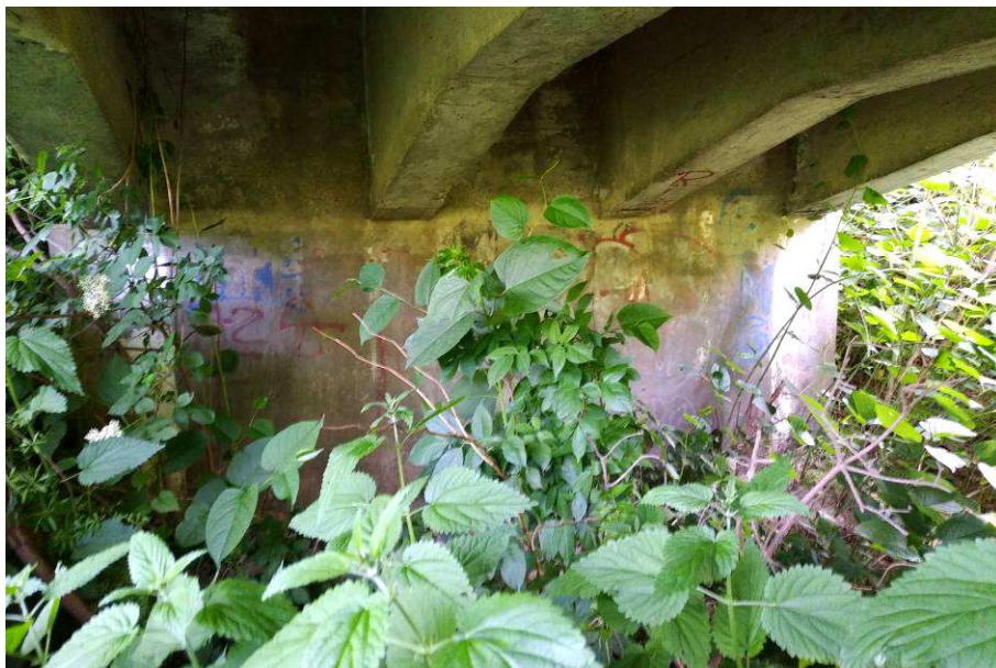
13. kép Jobb parti hídfő. A hídfő és felszerkezet beázik
