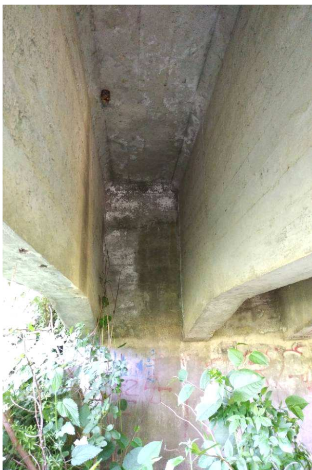
14. kép A háttöltés felől nagy mértékű a hídfők beázása. A híd hátoldalán lévő szigetelés hibás, vagy nincs is. A rövid ejtőcső miatt a víz a bordán folyik le jelentős korróziót okozva.
