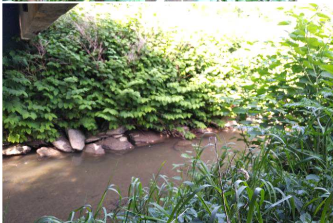
15. kép A híd alatti mederben kőszórás védelem van a híd előtti szakaszon védelemként. Ez mostanra kissé megbomlott. A híd környezete sűrű, tüskés növényzettel benőtt, így annak karbantartása és vizsgálata a rézsűkről nem lehetséges. A szárnyfalak és azok töltéslezárásai szintén vizsgálhatatlanok.
