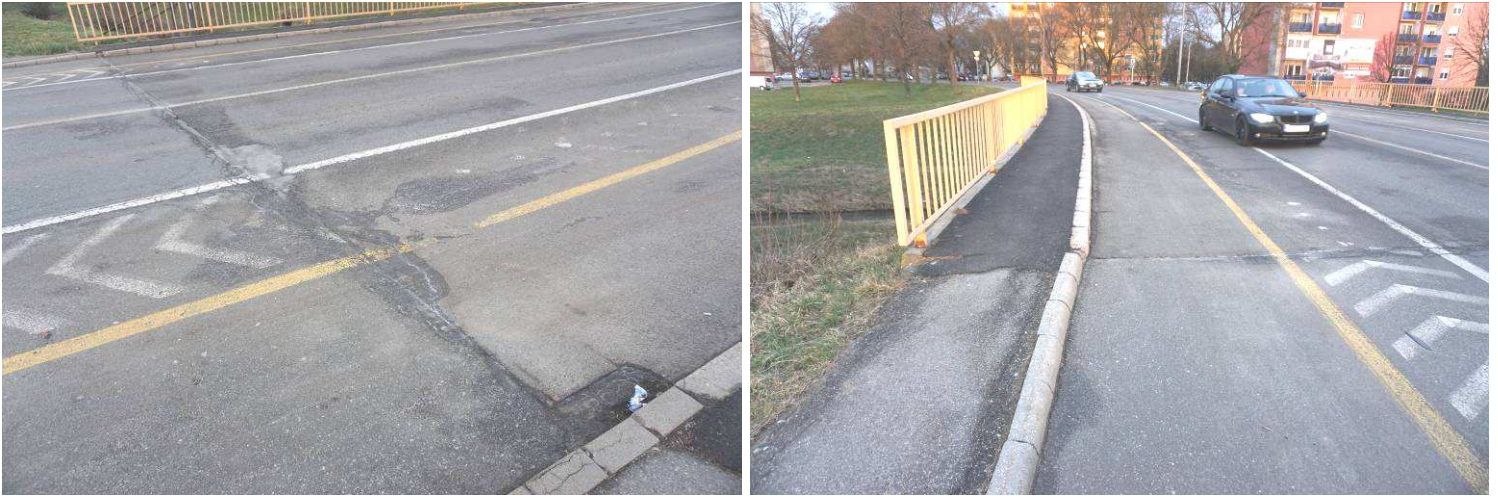
3. 4. képek: A hídpálya és a csatlakozó aszfaltburkolatok repedezettek, nyomvályúsak, helyenként kátyúsak. Dilatáció egyik hídvégen sincs. A járdacsatlakozások megsüllyedtek, repedések kezdenek kialakulni. A járdákon lévő újszerű hengerelt aszfaltburkolat nem vízzáró, az alattuk lévő tartószerkezetbe továbbra is csapadékvíz jut. Korlátoszlopok alsó része erősen korróziós, a többi felületen kezdődő korrózió.
