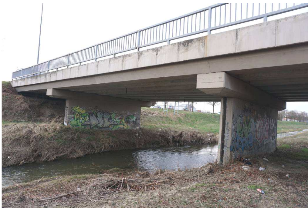
6. kép. Összefirkált, szennyezett pillérfelület, a tartószerkezeti elemek jó állapotúak. A meder az egyik oldalon pillér közelben jelentősen elfajult. Az előregyártott szegélyelemeken leázások, helyenként korróziós lefolyások nyomai, elkezdődött a betonvédelem leválása. A csepegtető csövek korróziósak.
