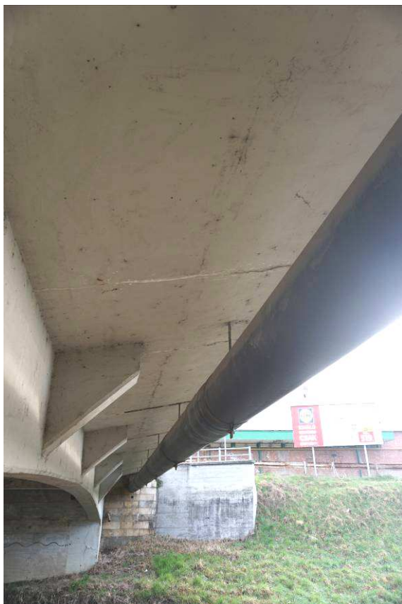
8. kép: Járdakonzol felületén meszes leázások és keresztirányú repedések láthatók.
