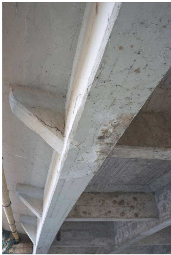
9. kép: Befolyási oldal hídközép. Konzoltámasz alsó része erőteljesen megrepedt a főtartó alsó részén is határozott repedések láthatók.
