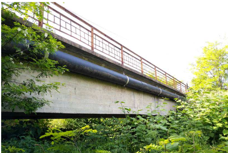
7. kép A sűrű akácok miatt a szárnyfalak nem vizsgálhatók. Előző vizsgálat során repedések voltak rajtuk.
