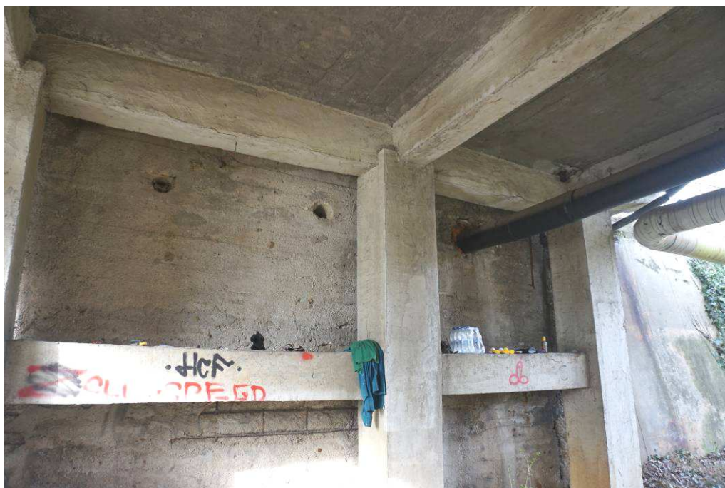
10. kép: A hídfőn történt közműátvezetés környezete nem vízzáró, a hídfőn betonleválások, acélkorrózió, meszes foltok láthatók. A keresztgerendán sarokrepedések alakultak ki.
