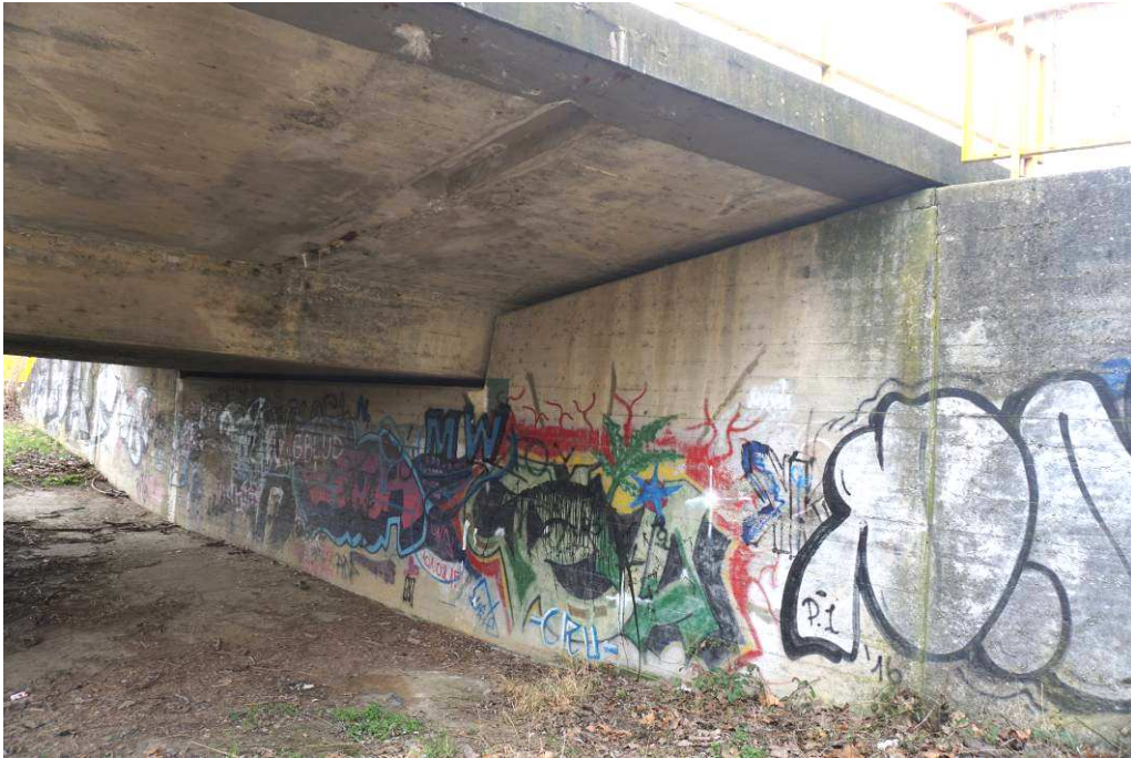
9. 10. képek: A hídvégeken a szerkezet mögé jutó víz a hídfőket és a csatlakozó támfalakat áztatja. A betonfelület több helyen fészkes, de vizsgálatuk a nagy mennyiségű graffiti miatt nehézkes.
