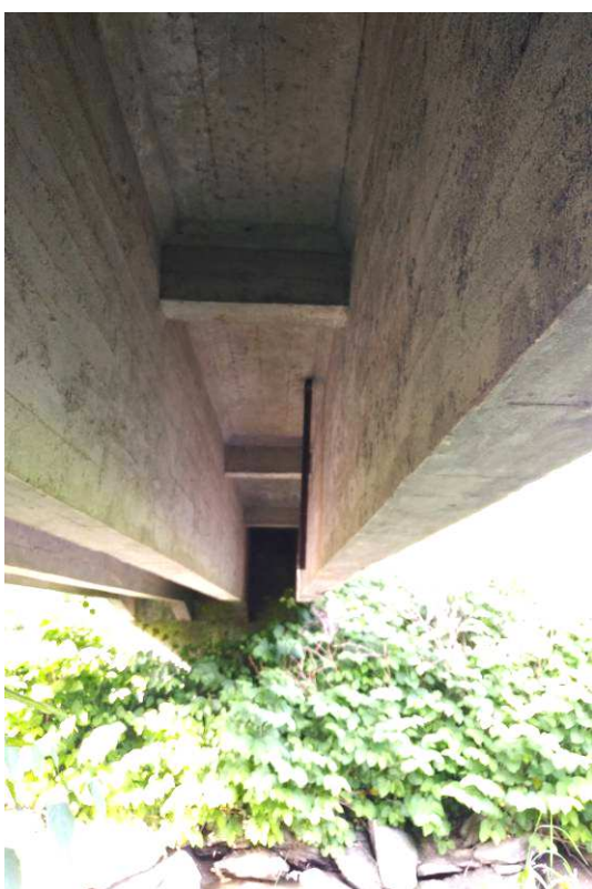
9. kép Felsőszerte az alsó síkján több helyen meszes kiválások a tartószerkezetet érő csapadékokra utalnak. Nagy valószínűséggel a szigetelés tönkrement a kocsipályán. A szivárgó ejtőcsöve rövid. A mederbiztosítás megbomlott.
