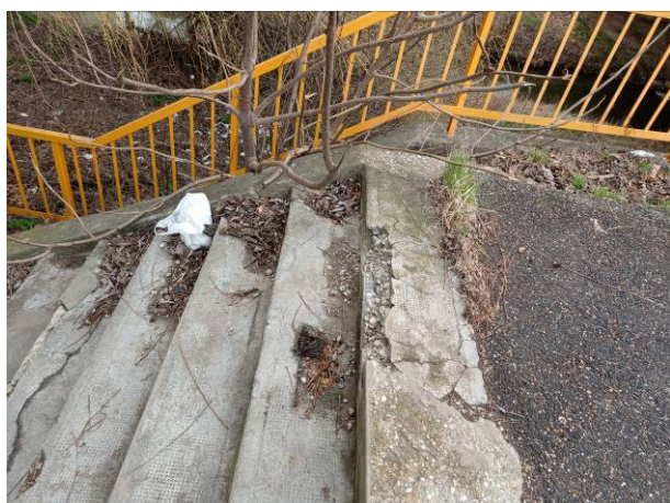
18. 19. 20. képek: A híd mindkét végén és mindkét oldalán lépcsők vannak, melyek közül egyet felújítottak. A többi lépcsőn fagykárók, leválások, élcsorbulások, növényzet benövése tapasztalható, melyek a biztonságos közlekedést nem teszi lehetővé.
