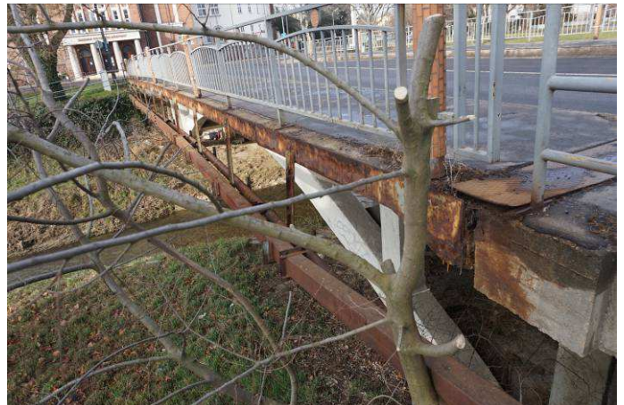
9. kép: Dilatáció feletti szerkezetek. Dilatációnál erős leázás és korrózió. Konzol oldallemezén a közmű tartószerkezetén, védőcsöveken, erős korrózió. Balesetveszélyes. A kinőtt fa a közlekedést akadályozhatja, a közművet veszélyeztetheti.
