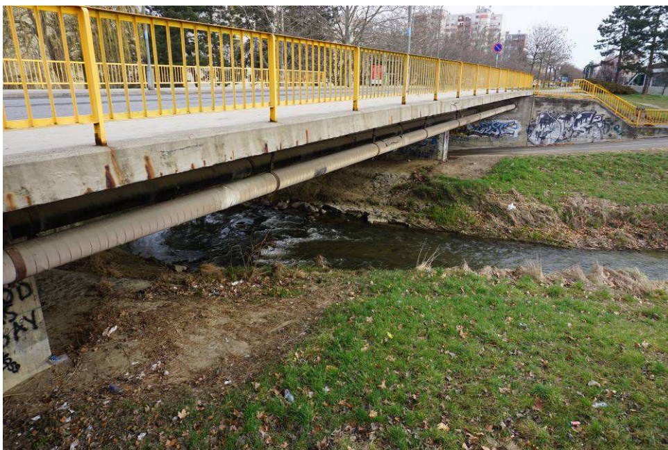
8. kép: A konzolvégeken vízszintes repedések, korróziós lefolyások, korlátoszlopok talpai erősen korrodáltak ugyanúgy mint a közművezték tartóbilincsei. A pillérvédelem kőburkolata szétbomlott, hiányos, errodálja a rézsűt.
