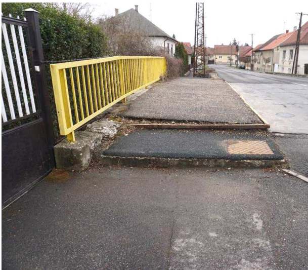
3. kép: Aszfaltburkolat vízáteresztő, az élvédő szögacél levált. Balesetveszélyes a járdacsatlakozás. A szárnyfal betonteteje és a járda-aszfalt betonja erősen málik. A második korlátoszlop a „levegőben lóg”.
