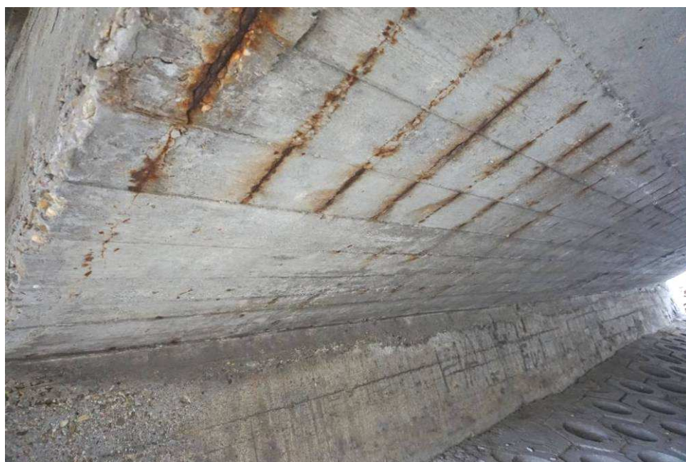
13. kép: A bal oldali hídfő felülete cementpéphiányos, meszes leázási foltokkal. A felszerkezeten itt is a korróziós betonacélok mutatkoznak, melyek a betonfedést továbbra is lerepesztik. A felszerkezeten leázásnyomok is mutatkoznak, amely a szigetelés hibájára utal.
