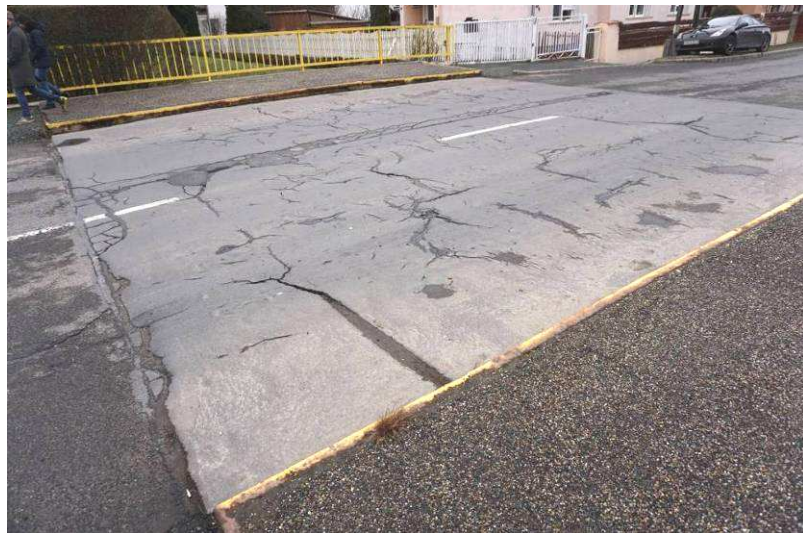
4. kép: A híd útburkolatának öntött aszfaltja erősen repedezett, nyomvályús. A hídvégek burkolata is rossz állapotú, a kiöntések környezete repedezett, a háttöltések megsüllyedtek. A nyílásokon keresztül a csapadék a szerkezetbe jut.
