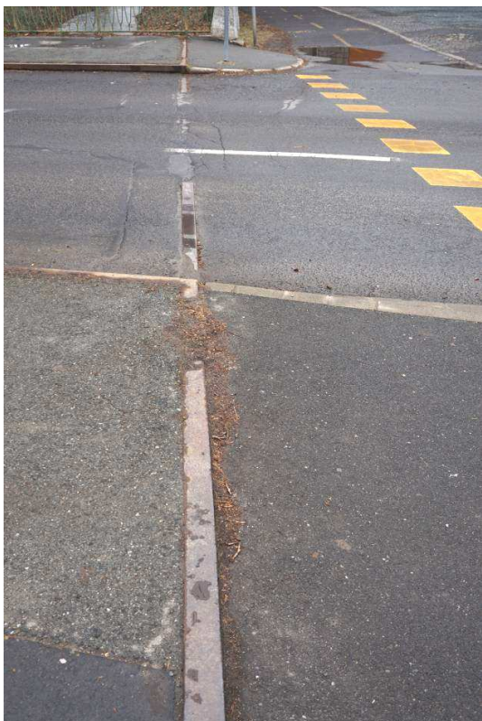
3. kép: A hídvégeken lévő dilatációnak alkalmazott szögacélok korróziósak, hullámosak, rugalmas tömítés nincs.
