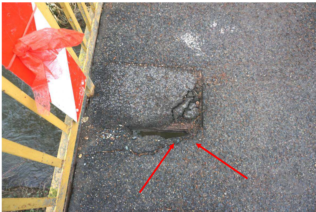
3. kép: A híd aszfaltburkolata repedezett, hiányos.
