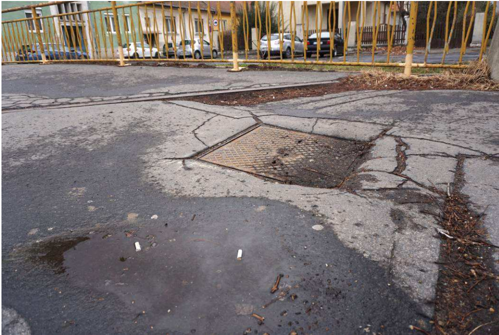
3. kép: A hírhoz csatlakozó járda rossz állapotú. Balesetveszélyes. A dilatáció körül a burkolat erősen repedezett, megsüllyedt, a hídszélen a növényzet megtelepedett. Akna fedlap megsüllyedt.
