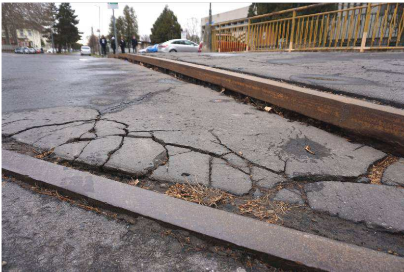
4. kép: A szegély szögacél alatti résen a csapadékvíz és a jégtelenítő só a szerkezetbe jut.
