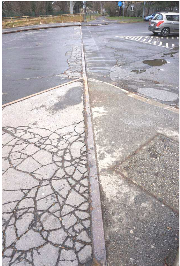
5. kép: A dilatáció környezetében az aszfaltburkolat erősen repedezett. A dilatációként szolgáló szögvas megsüllyedt és korróziós felületű, környezete tömítetlen, a csapadékvíz a szerkezetbe jut.
