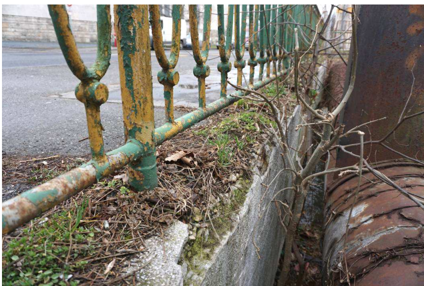
4. kép: A szegély állapota nagyon rossz, melyet a erős növényzet tovább ront. A közmű közelsége miatt a hídszegély megfelelő felújítása nem lehetséges.
