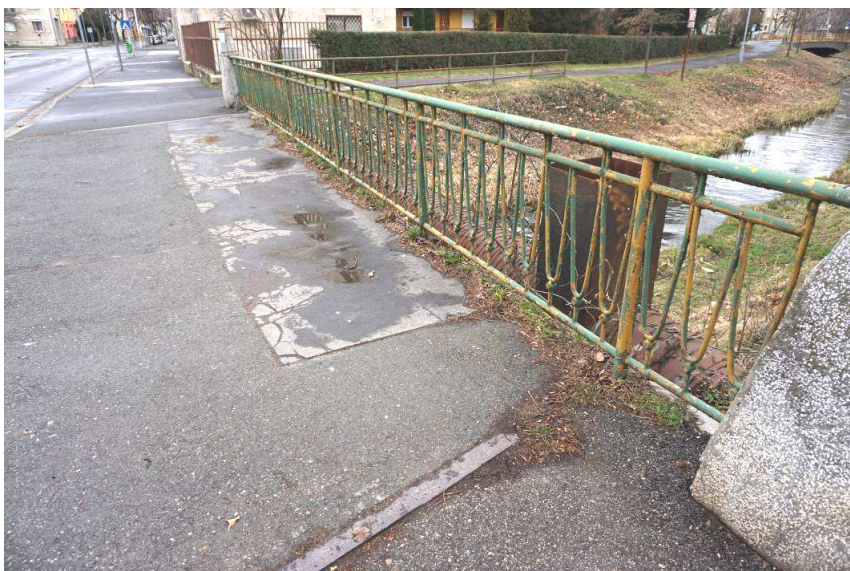
5. kép: A járdák felülete részben öntött aszfalt, részben hengerelt aszfalt. A burkolat nagyrészt repedezett, a mélypontokban megáll a víz. Korlátról hámlik a fedőréteg, az oszloptövek korróziósak. A szegélyek szélén erős növényzet van, mely a szerkezet tönkremenetelét felgyorsítja.
