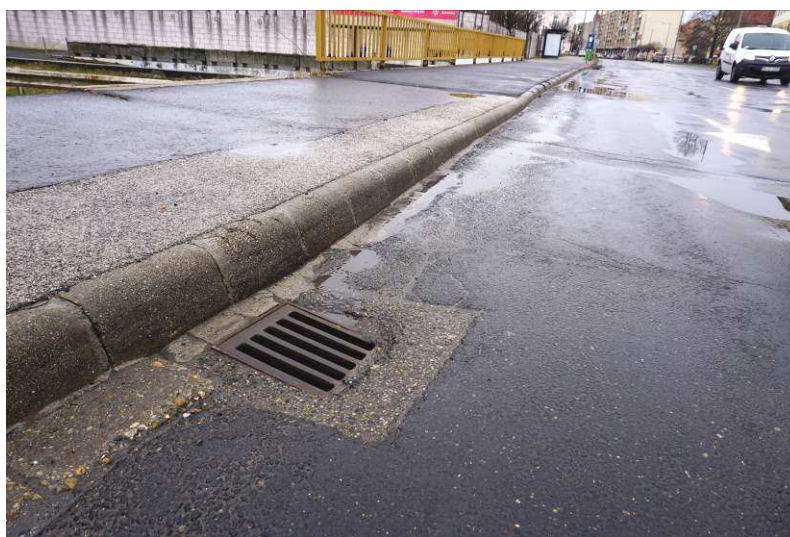
5. kép: A hídpályáról a csapadékvíz csak részben jut el a víznyelőig a rossz burkolat miatt.
