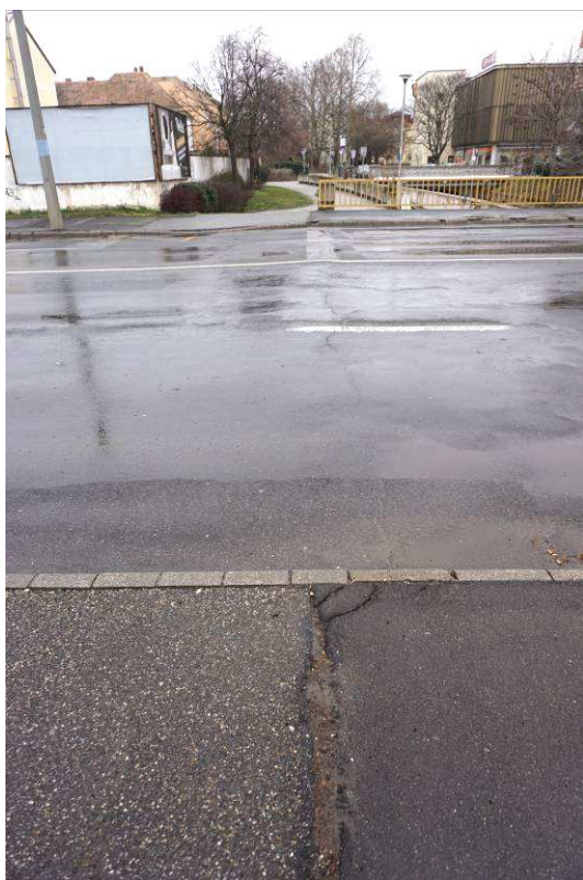
4. kép: Dilatációk helyén a burkolat átrepedt, a háttöltések megsüllyedtek. A járdacsatlakozásnál a hézag megnyílt és nem vízzáró.
