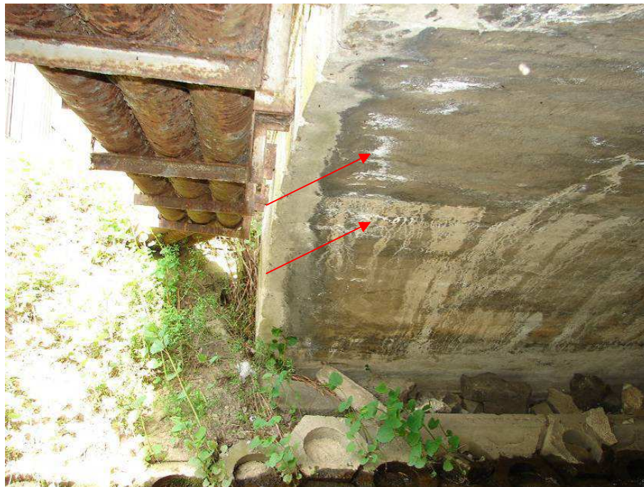
15. kép: A befolyási oldalon a boltozatba jutó csapadék tovább gyengíti a szerkezetet a boltozaton keresztirányban húzó repedések látszanak. A boltozat mellvéd alatti sávja erőteljesebben leázik. A homlokfalon felerősített közművek korrodáltak.
