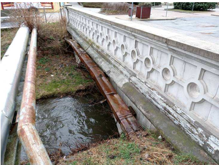
5. kép: Kifolyási oldalon a téglatámfalon meglepedett a növényzet, mely elindította a téglafal tönkremenetelét. A közművezetékek itt is a boltív tartószerkezetét terhelik. A hídra rögzített közművek nagy valószínűséggel nem „élő” vezetékek. (Lásd e-közmű.)
