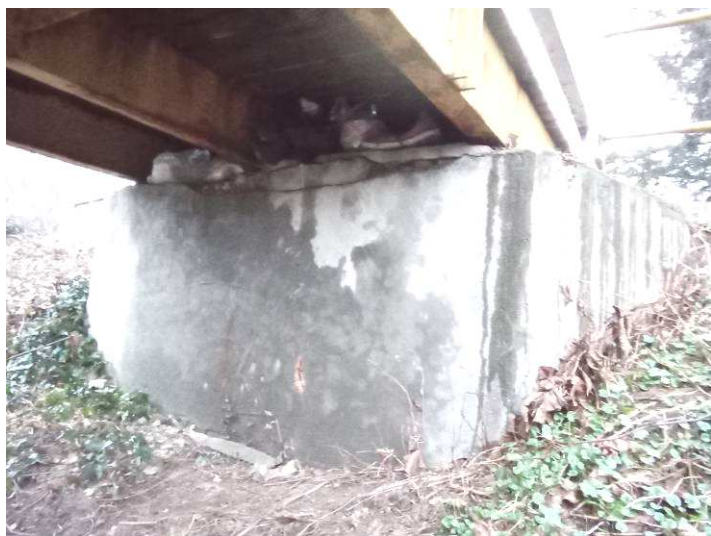
5. kép: Acél főtartók a beton hídfőkre támaszkodnak, nincs saru, ezért a hídfő felső síkján a beton elrepedt.
