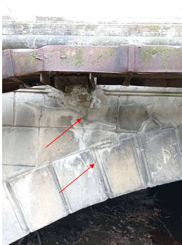
13. 14. képek: A boltívben keresztirányban futó repedések több helyen a külső síkon is „felfutnak” ezzel jelezve, hogy a szerkezet átrepedt. A közműrögzítések a boltív leázását tovább fokozzák és a szerkezetet gyengítik.
