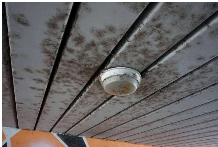
20. kép: A közvilágítás környezetében erőteljes penészedés alakult ki.
