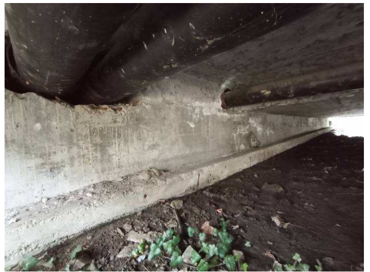
7. kép A hídfők közműátörései tömítetlenek. A hídfők felületén meszes leázások láthatók. A cölöpösszefogó gerendák oldalsíkján kilátszó korróziós betonacélok láthatók. A mederben feliszapolódás, lerakódott hordalék.
