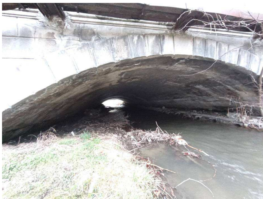
16. kép: A patak sodorvonala elfajult, áttevődött a híd egyik hídfője felé. A mederben felgyülemlett uszadék, hordalék látható. Sejtidomkövel burkolt meder helyenként megsüllyedt, hiányos.
