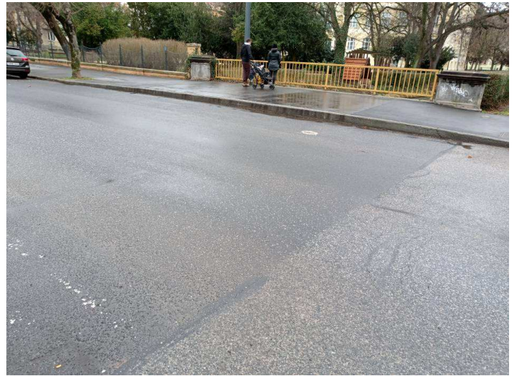
4. kép: A jobb oldalon a járda burkolatának egy részét öntött aszfaltról hengerelt aszfaltra cserélték. A hídvégen irányított repedés és rugalmas kiöntés nem készült. (Sem a járdán, sem a kocsipályán.)
