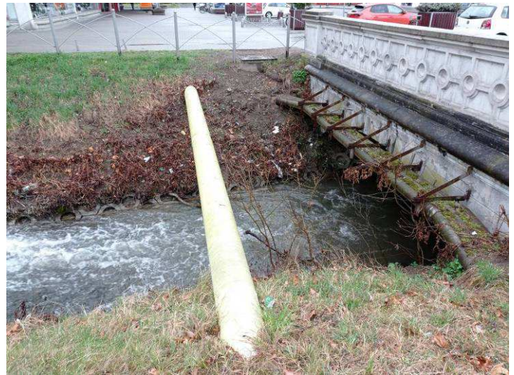
4. kép: Befolyási oldalon a híd boltív oldalára felfüggesztett vezetékek terhet jelentenek az amúgy is repedezett boltívnek. A szemközti rézsűn erózió figyelhető meg.
