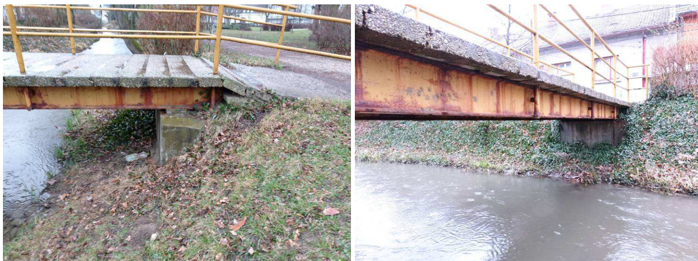
3. kép: Járda csatlakozása balesetveszélyes, alatta üregelődés alakult ki a háttöltés lezárás hiánya miatt. Korlátrögzítések erősen korrodáltak.
