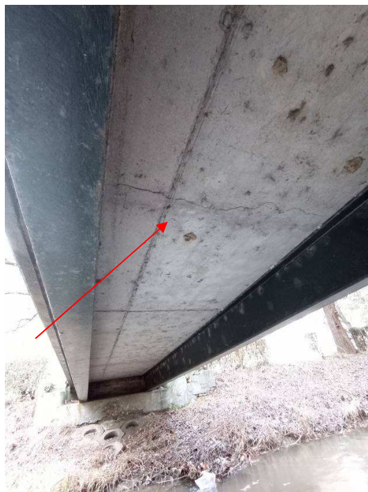
4. kép: Az acél főtartók nagy részben jó állapotúak, kisebb acélkorróziós foltok láthatók a felületükön.
