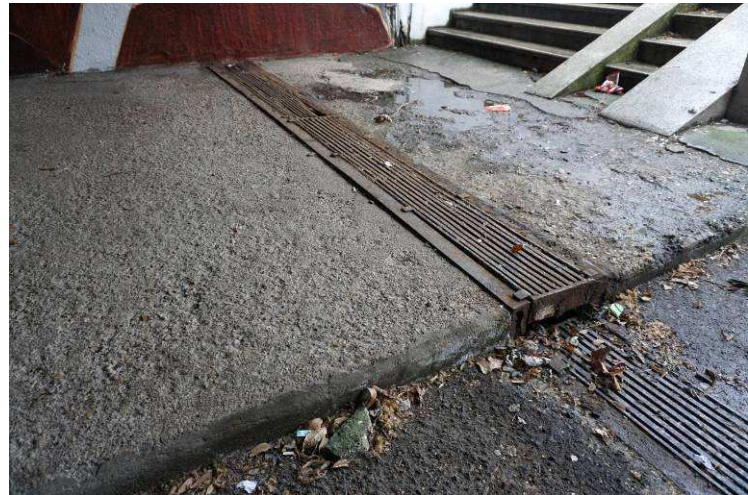
15. kép: A lépcső alján lévő betonjárda rossz minőségű, felfagyott. A folyókarácsok némelyike deformálódott.
