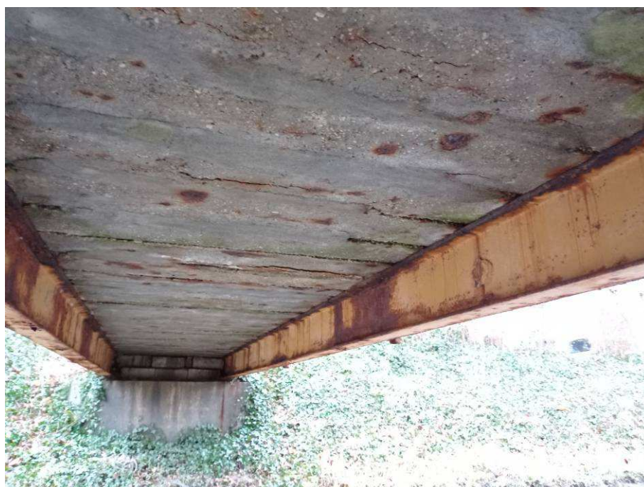
4. kép: Korrózió az acél tartók felületén, a felső és alsó övön előrehaladott, valamint a saruk környezetében. Felszerkezet vasbeton pallókból kialakítva, melyek helyenként élleváltak, alsó felületükön korrózió, ázásnyomok, rozsda és mészfoltok. Vízzor kialakítás és járható szigetelés nincs.
