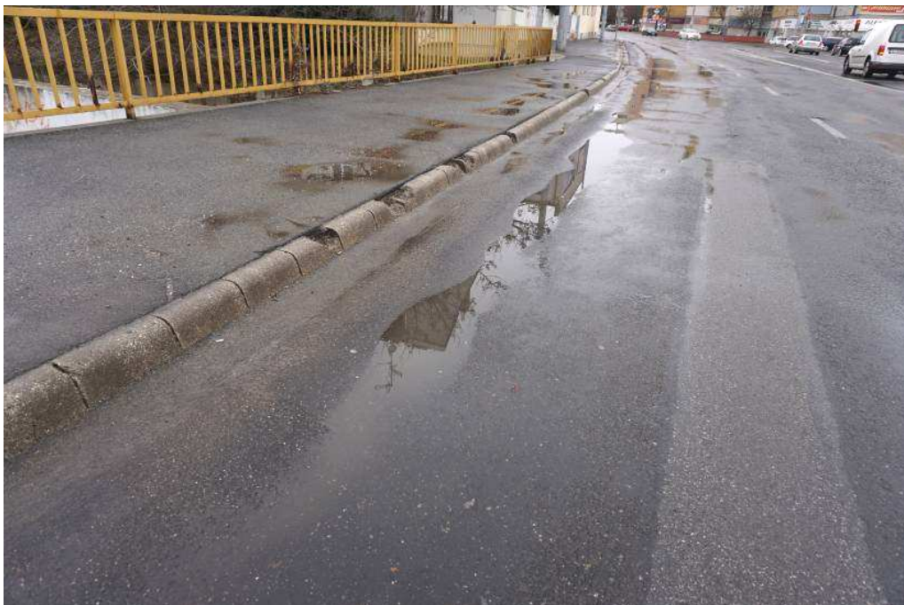
3. kép: A nyomvályús burkolaton és a járda mélypontjaiban megáll a víz. Szegélyelemek nagy mértékben betonhiányosak.
