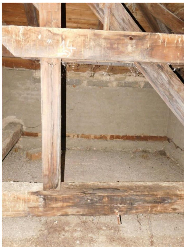
51. ábra: Vascső által bevezetett víz okozta korhadás kötőgerendán 1
