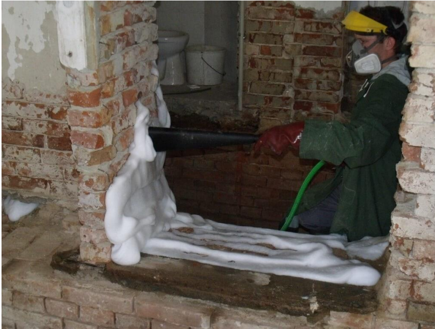
4. ábra: A pince habosítós gombamentesítése 2015-ben a földszinten
