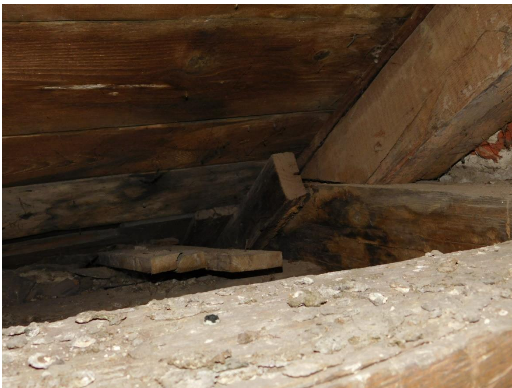
18. ábra: A tetőburkolat hiányossága miatt beázott tetődeszkázat
