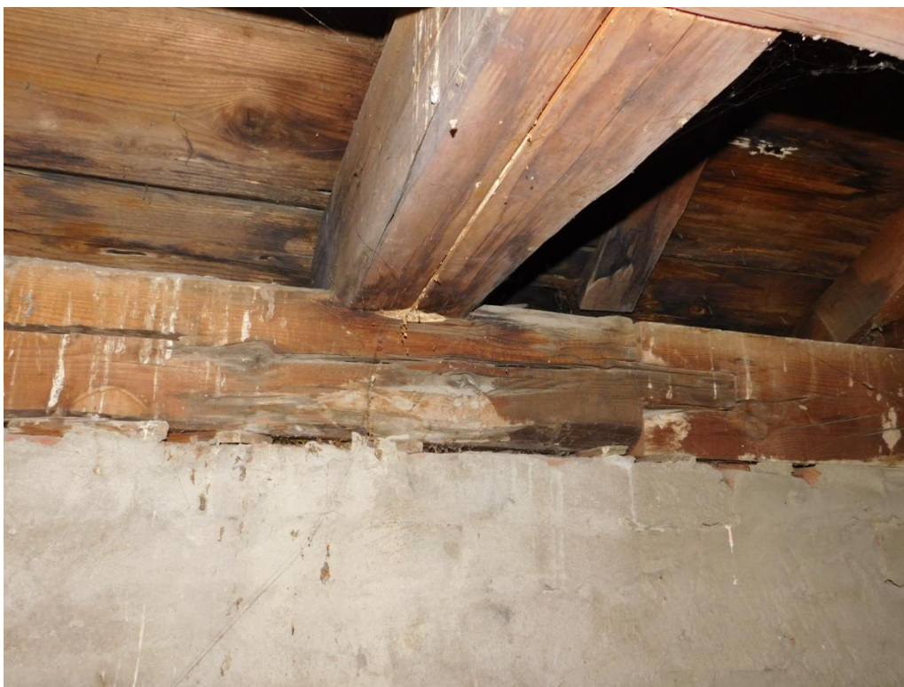
53. ábra: Repedt fiókgerenda, házi kéreggomba okozta károsodás a csomópontban, sárgerenda-felsőn és annak hosszoldásában
