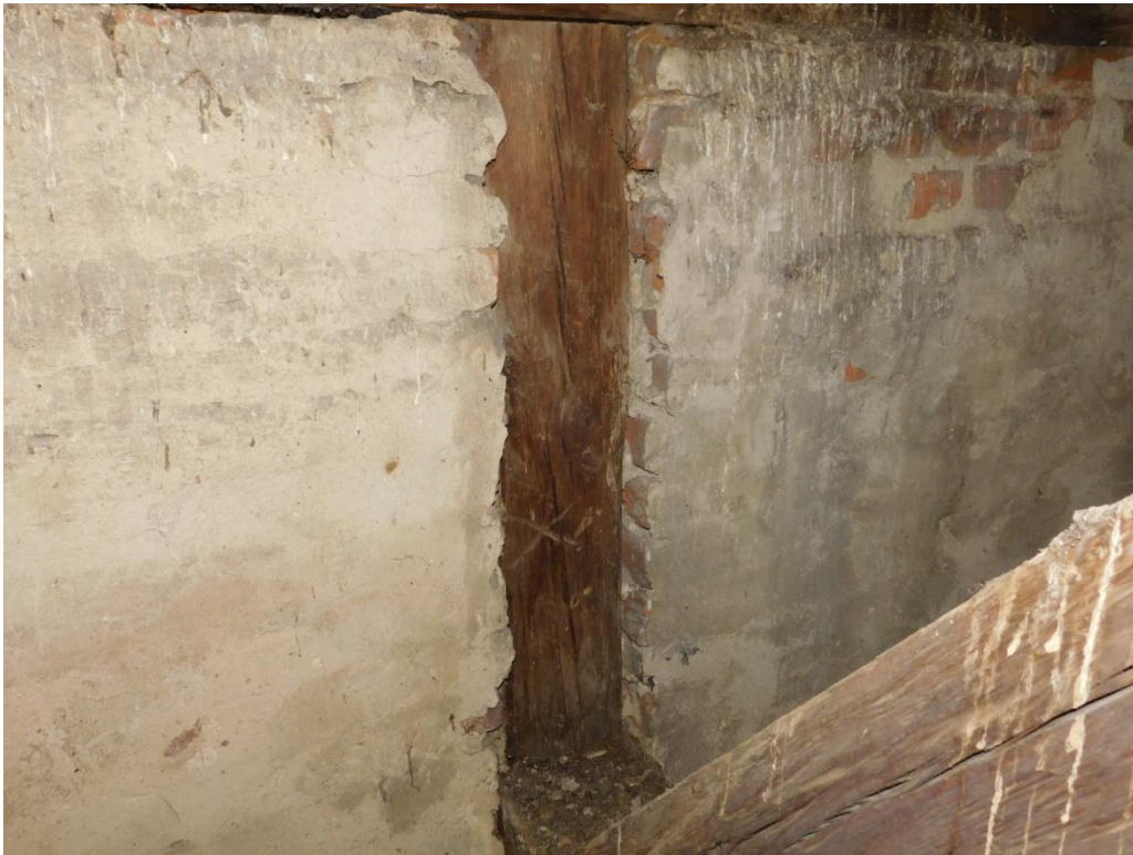
45. ábra: Teljesen falba beépített távtartó
