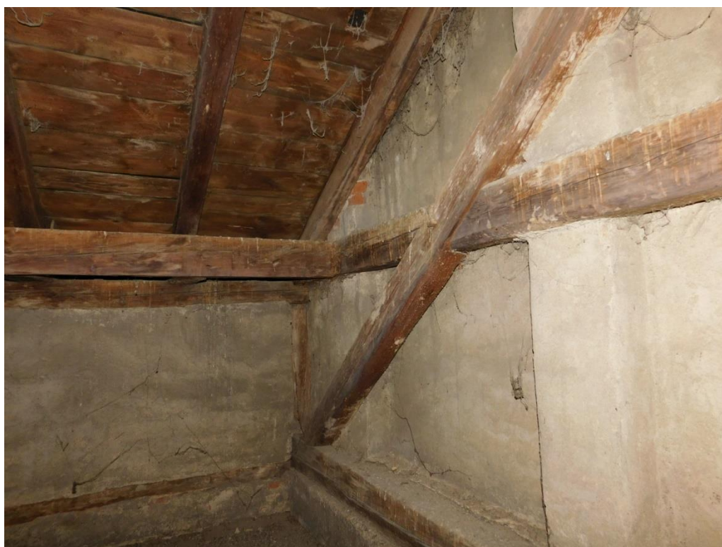
16. ábra: Pontszerű beázások és fal mellett beépített szerkezeti elemek
