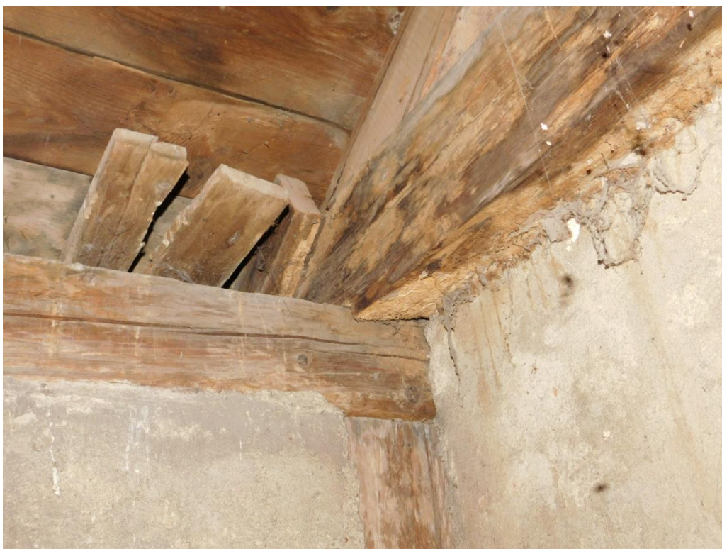
17. ábra: Felületi degradációk, repedések tartószerkezeti elemeken
