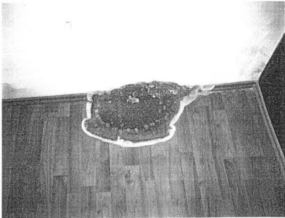
3. ábra: Könnyező házigomba termőtest az épület földszintjén, szalagparkettán 2015 januárjában (Forrás: Faanyagvédelmi szakvélemény, Dr. Varga Ferenc faanyagvédelmi szakértő)
