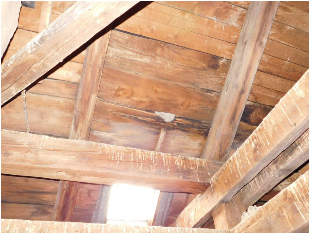
48. ábra: Tetőablak feletti beázás miatt kialakult korhadás
