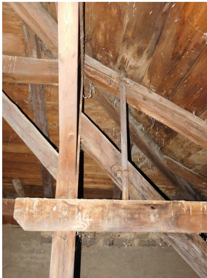
50. ábra: Vascsó melletti beázás és korhadások szerkezeti elemeken
