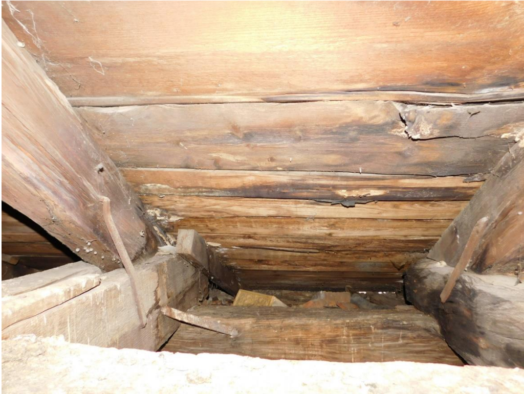
37. ábra: Beázott, korhadt tetődeszkázat, mellette ugyancsak beázásból származó korhadás szarufákon, fogópárákon és fiókgerendán
