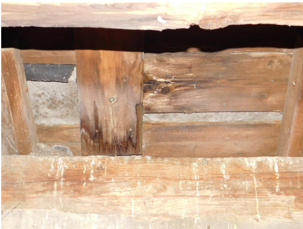
34. ábra: Hiányos tetődeszkázat, látszó palafedés, korhadt szerkezeti faanyagok
