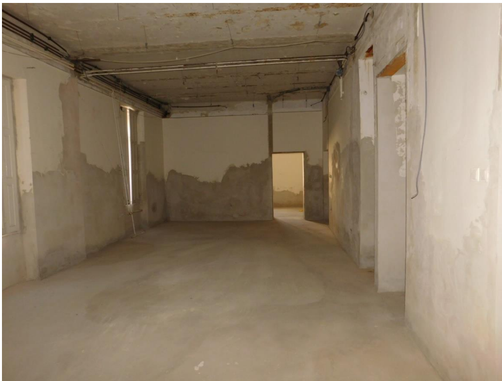
68. ábra: Gombamentesítéssel érintett földszinti helyiség
