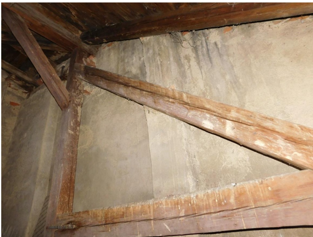
24. ábra: Hosszirányú, szilárdság csökkentő és fertőzési kapunak számító repedések dúcgerendán
