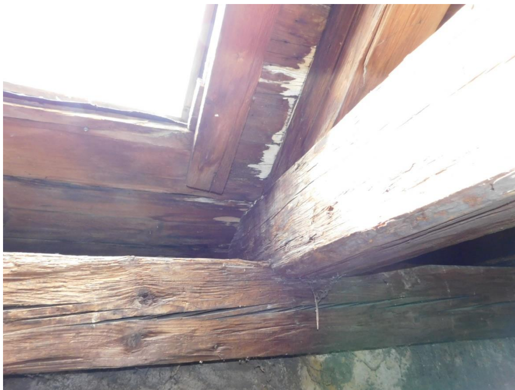
27. ábra: Nyitott tetőablak melletti Házi kéreggomba károsítás és repedt sárgerenda-felső
