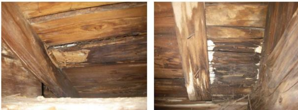
8. ábra: Házi kéreggomba fertőzési helyek az épület tetőszerkezetében (Forrás: Szemleszintű faanyagvédelmi szakvélemény 2015, Nyáry Péter faanyagvédelmi szakértő)
