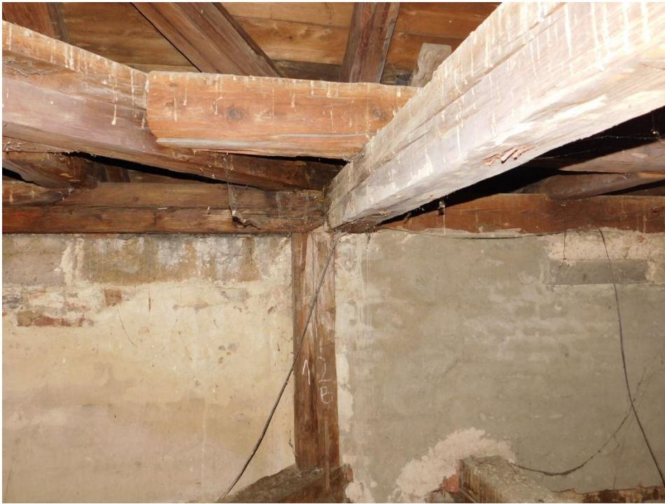
49. ábra: Száradási repedések szerkezeti elemeken
