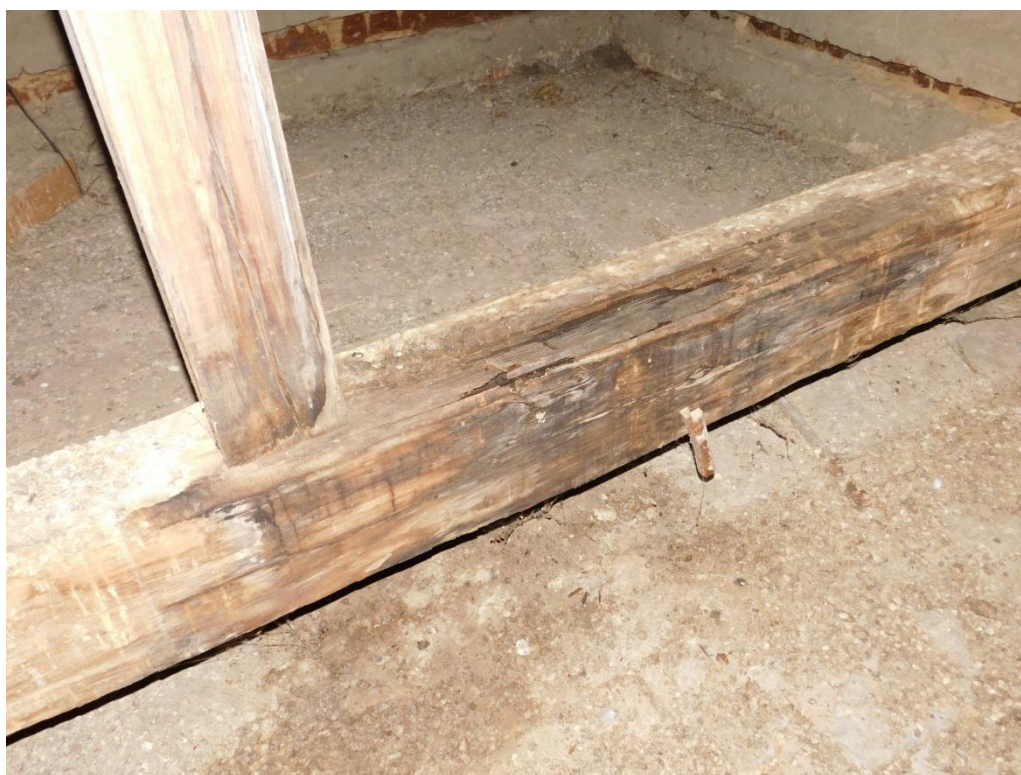
52. ábra: Vascső által bevezetett víz okozta korhadás kötőgerendán 2
