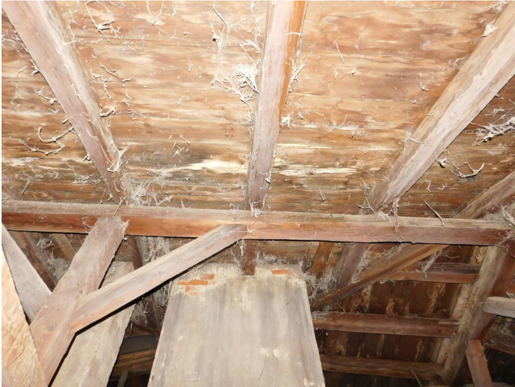
43. ábra: Több négyzetméteren beázott, korhadt tetődeszkázat
