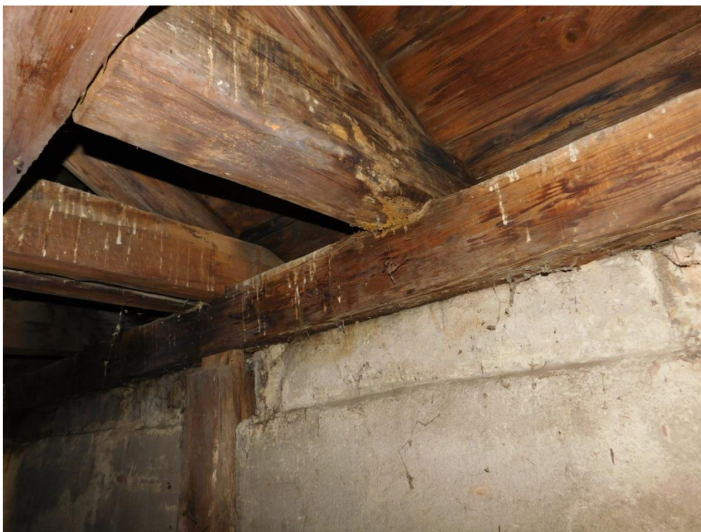
35. ábra: Korhadt fiókgerenda, sárgerenda-felső csomópont, mellette a falba beépített távtartó kicsúszott a sárgerenda-felsőből
