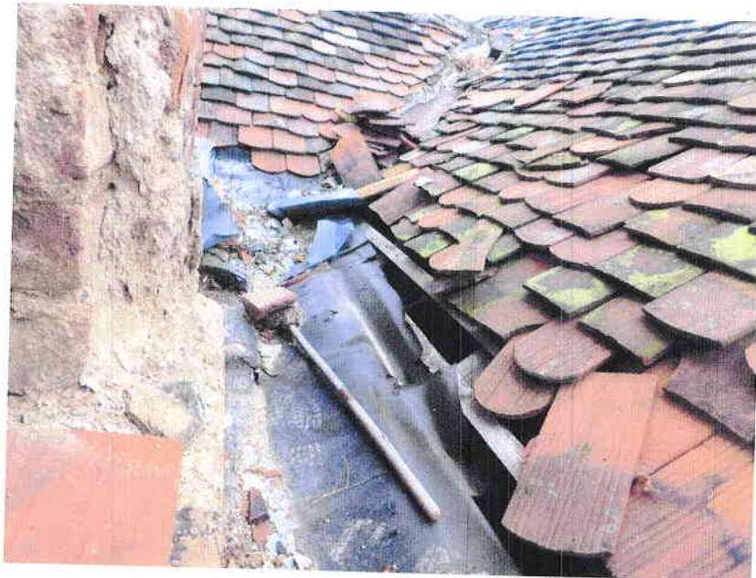
7. ábra Tönkrement tetőburkolat és ereszcatorna az emeleti helyiség külső falzatánál
