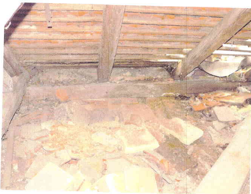
10. ábra Beázás a tetőszerkezetben 2
