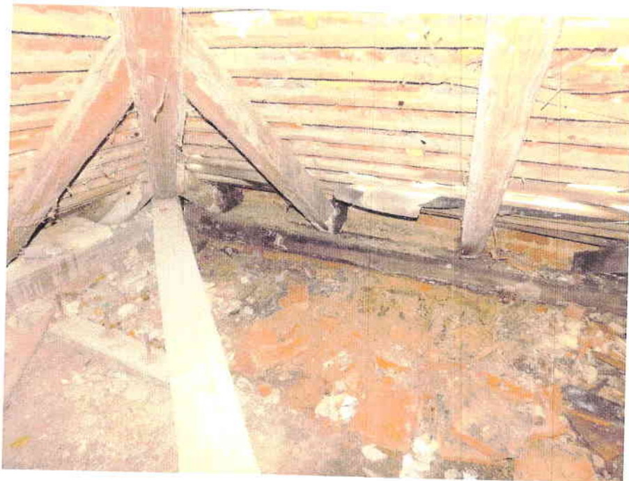
9. ábra Beázás a tetőszerkezetben 1 (kapcs. 7. ábra)
