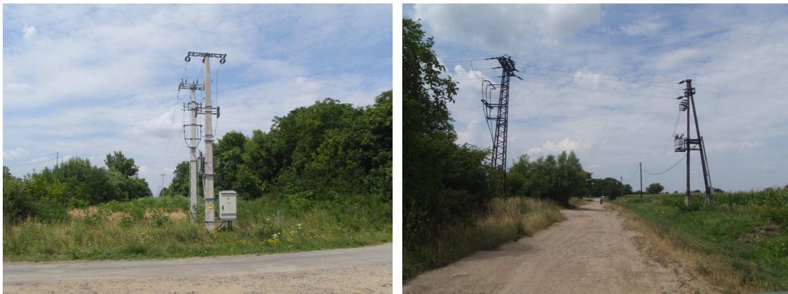
A terület villamosenergia ellátása (BVI északi sarkán és a Szombathely repülőtér megállóhely közelében)
