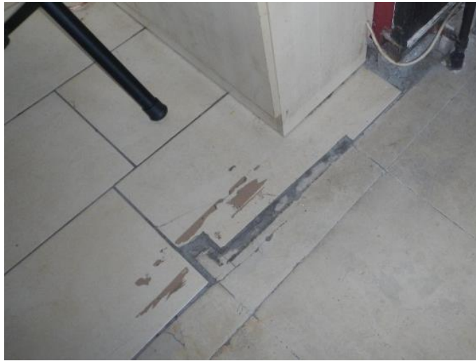
A 2007-es Szimfónikusok átalakításakor félbehagyott kivitelezés
