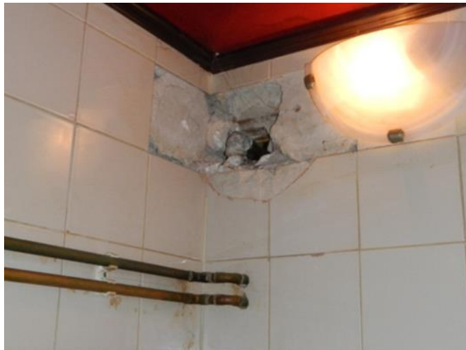
A 2007-es szimfónikusok átalakításakor szétvert és ugyhagyott falazat és csővezeték
