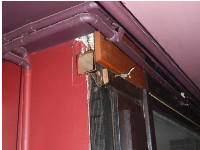
A 2007-es Szimfónikusok átalakításakor félbehagyott kivitelezés
