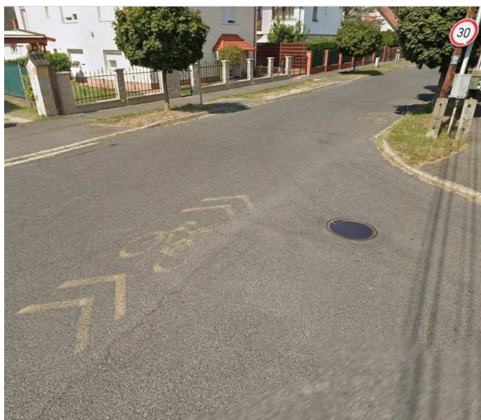
87. ábra: Megkopott útburkolati jelek a Maros utcában
